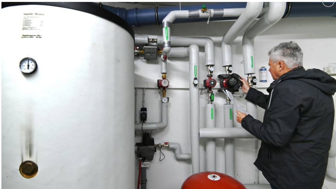
Ist noch gut, soll aber trotzdem weg: Gasheizung in einem Heizungskeller / dpa
